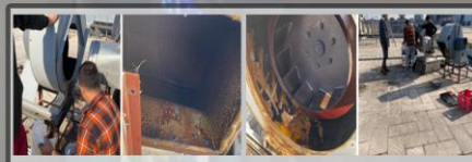
سرویس هواکش های فودکورت
